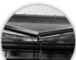
台風による 軒の破損
