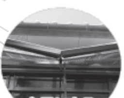
台風による 軒の破損
