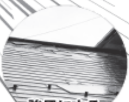
強風による 屋根の剥がれ
